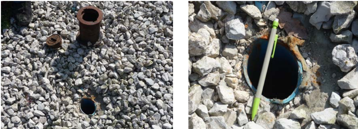
Figure 6 : Photos du piézomètre PZ2
